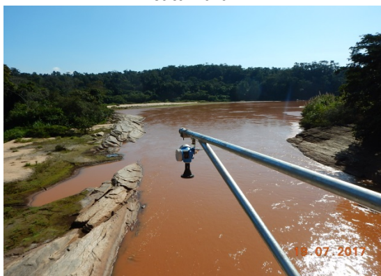
Figura 4: Registro de sensor de nível por radar.
