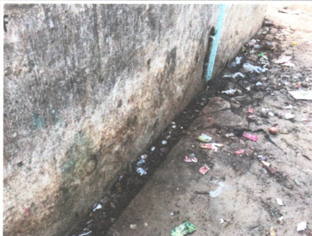
Foto 5: Sistema de drenagem da área de recepção obstruído.
