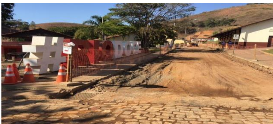
Figura 06 - Estradas danificadas no centro de Rio Doce.
