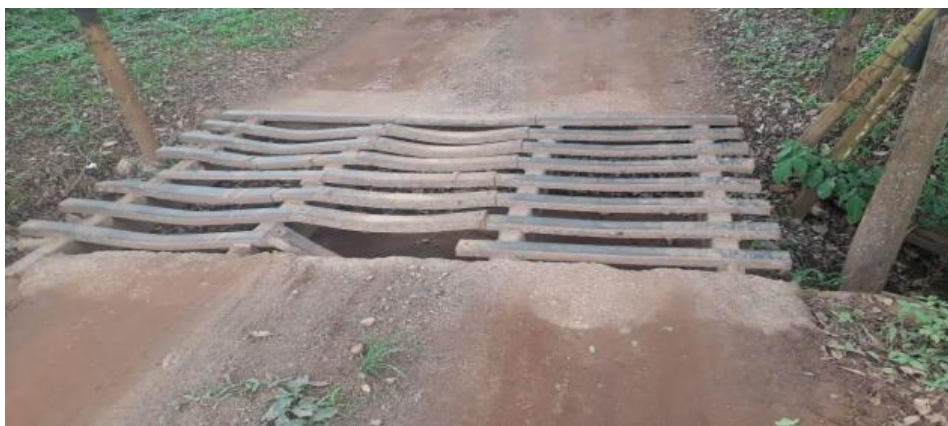
Figura 05 - Mata burro danificado
