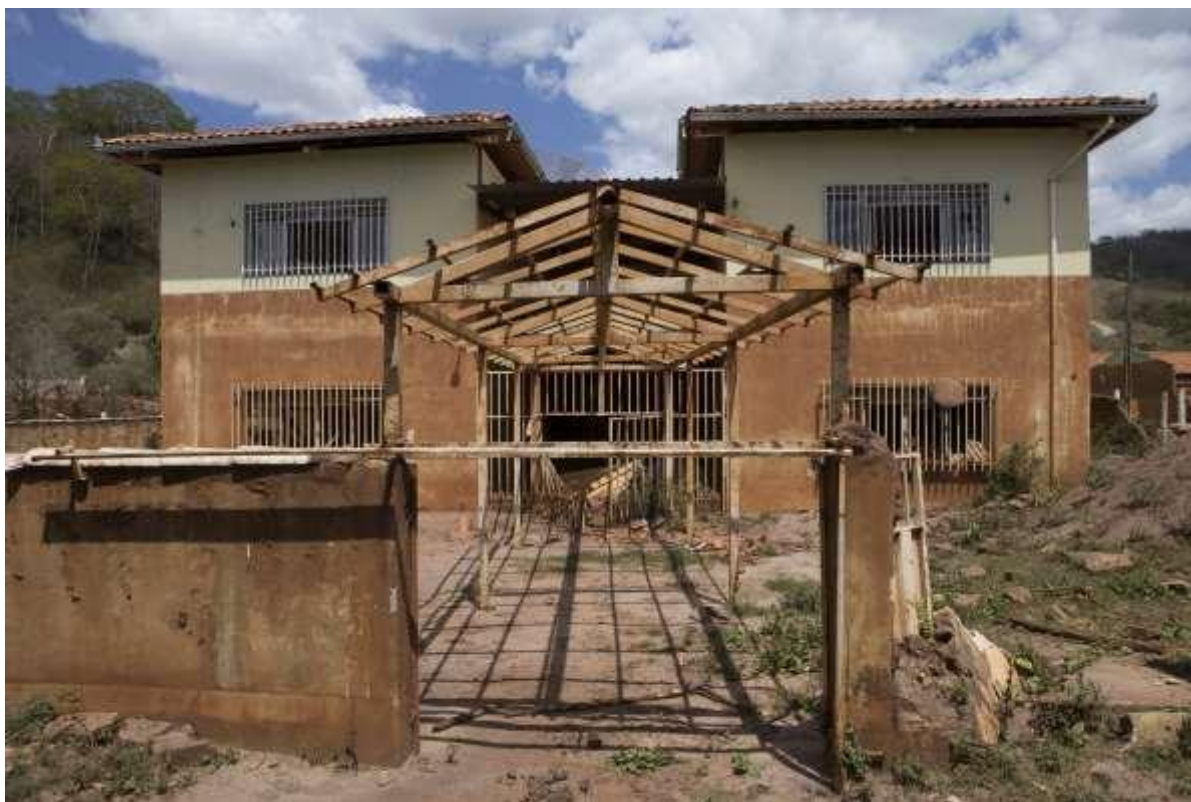
Figura 13 – Fachada da escola estadual depois da lama da Samarco
